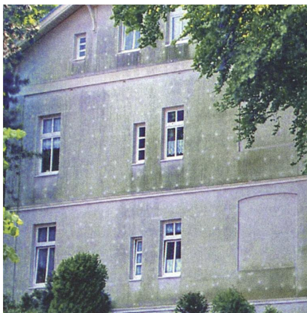
Fig. 1 - Tipico degrado algale su facciata con ETICS (External thermal insulation composite systems) - (Germania).
