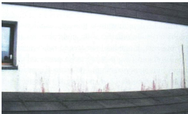
Fig. 2 - Contaminazione algale su una parete per accumulo di acqua in prossimità dell'innesto parete-tettoia. Il degrado raggiunge un'altezza di 1,60 m.
