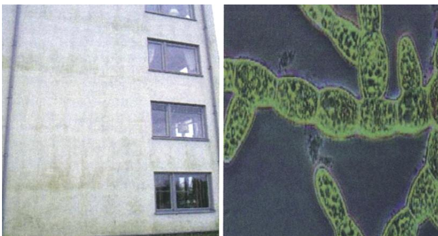
Fig. 5 - Contaminazione biologica da parte di microalghe su una facciata leggera.
